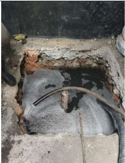
Foto No. 8. Lavado alrededor de la boca del pozo
